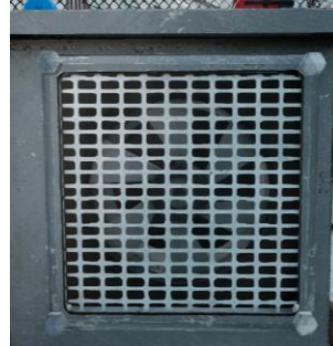
Fan inside the HVAC units
